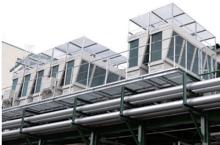
ヘキサゴンフォース32 (50馬力) 7台を、既設機の1/2スペースで設置。
