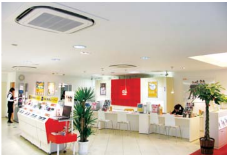
店内は広々していて明るい雰囲気。3台のエアコンが空気をしっかり除菌しています。
