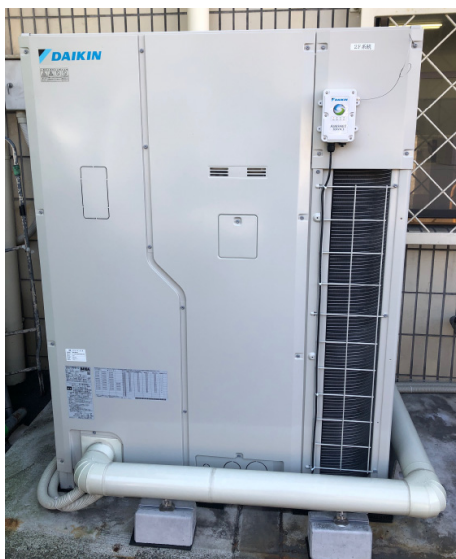
納入後（室外機）
