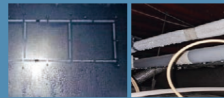
暖かい外気が侵入し、エアコン本体や配管などに結露が発生
