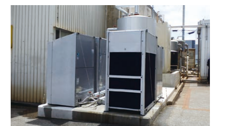
麺類製造メーカー 高温蒸気の省エネ昇温用として採用。調理工程の加温や 器具洗浄にも使用。
