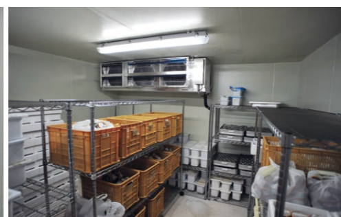
ジェラート製造工場 他社冷却ユニットと接続して冷凍庫の冷却に採用
