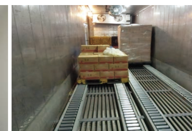
ソース製造工場 現状は冷凍での使用 将来的にいつでも冷蔵庫としても使えるよう対応。
