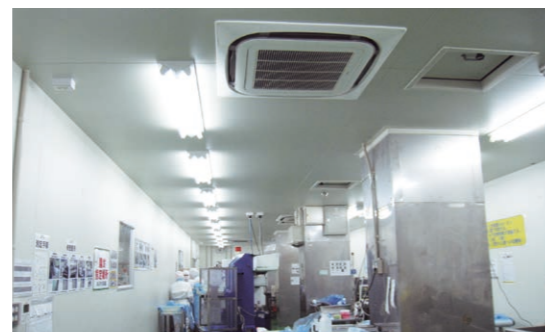
本事例は天井埋込カセット形 ラウンドフロータイプです。
