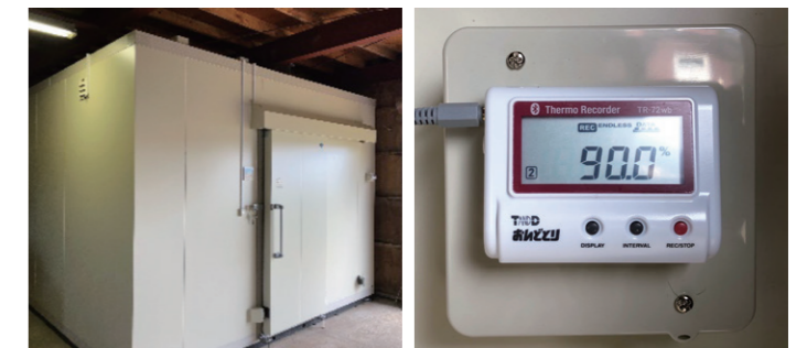
倉庫内に新築されたホシザキのプレハブ庫
