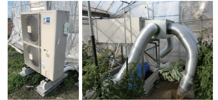
側面にIoT端末が設置された室外機
