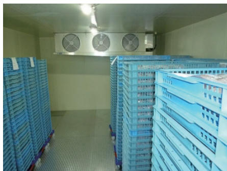
プレハブ冷凍庫内の庫内ユニット
