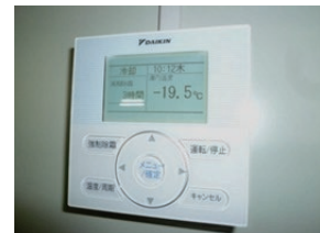
庫内温度を常時監視
