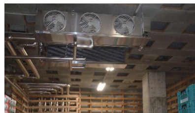
冷蔵庫内設置状況
