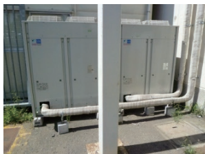
20馬力冷凍機(庫外ユニット)を2台配置。
