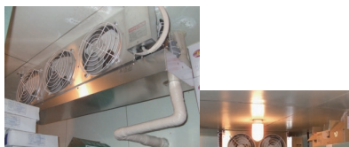
冷凍庫内設置状況 (冷凍5馬力)
